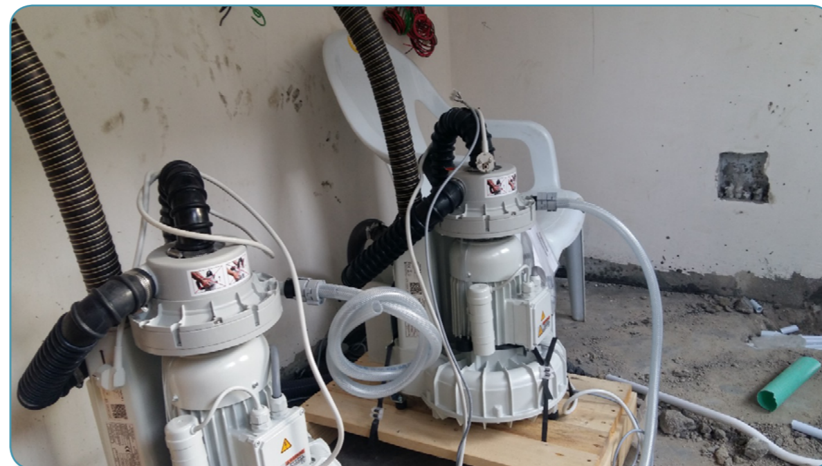
Salle des machines : Installation des compresseurs et du système d'aspiration
